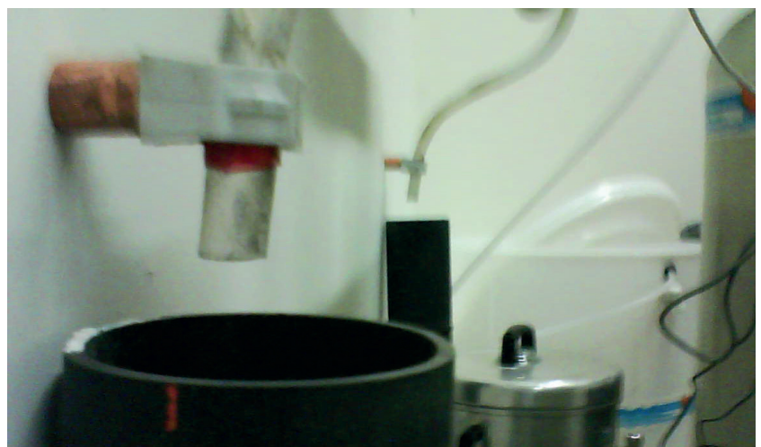
Correcte afvoer van het spoelsysteem van de waterontharder
