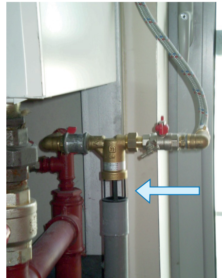
De afvoer van de boiler is duidelijk gescheiden
